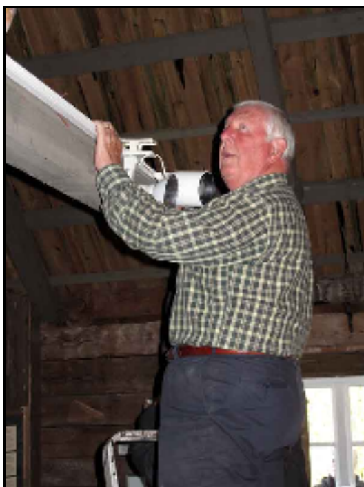
Att belysningen inte är den bästa har även Jan-Åke Kristofferson konstaterat och tar mått för nya armaturer.
